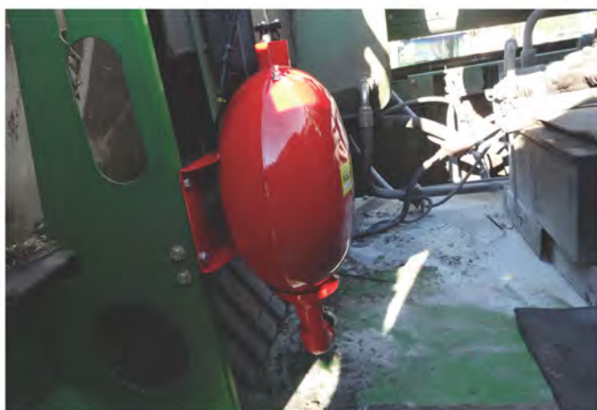
Элементы системы пожаротушения комбайна John Deere
